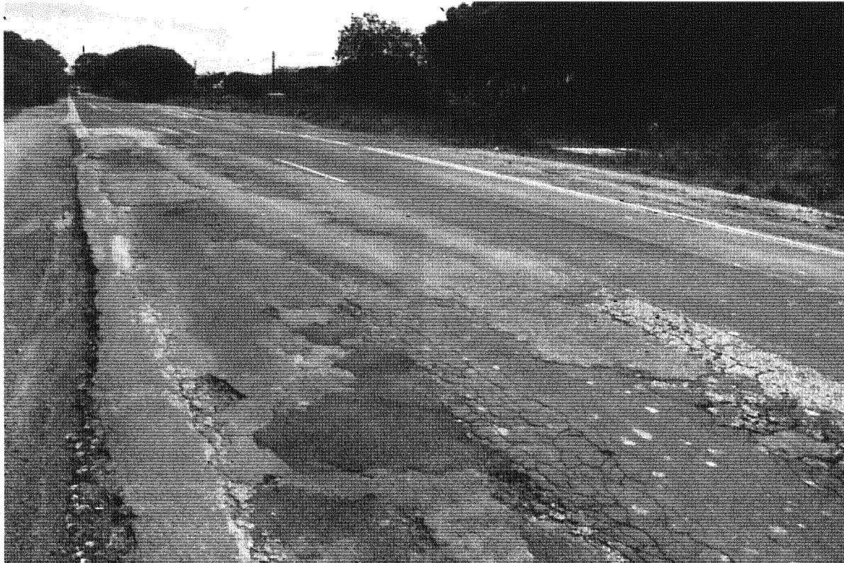
O troço da en125 entre Vila Nova de Cacela e Vila Real de Santo António, à passagem pelo concelho de Castro Marim, é o que está mais degradado
