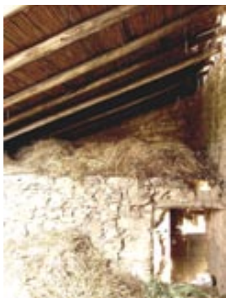
Caniço, no revestimento interior de cobertura de palheiro. Pomar, Vila Real de Santo António
