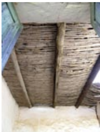
Caniço, no revestimento interior de cobertura de habitação. Portela, Alcoutim
