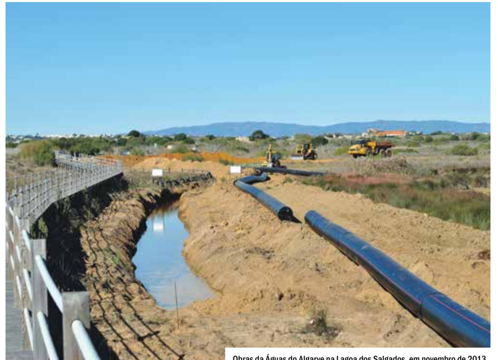
Obras da Águas do Algarve na Lagoa dos Salgados, em novembro de 2013.
