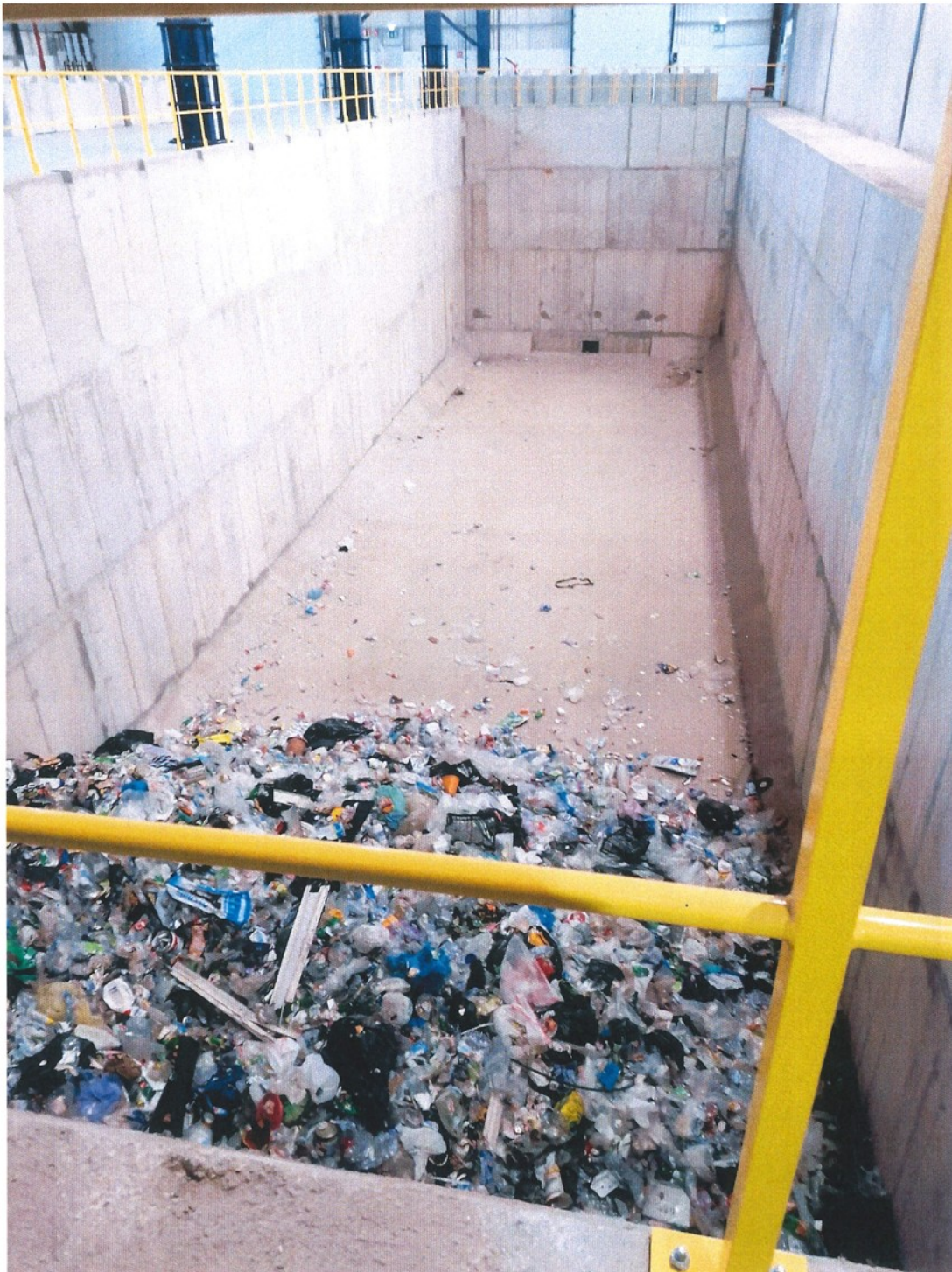
Fosso de descarga de resíduos para posterior triagem
