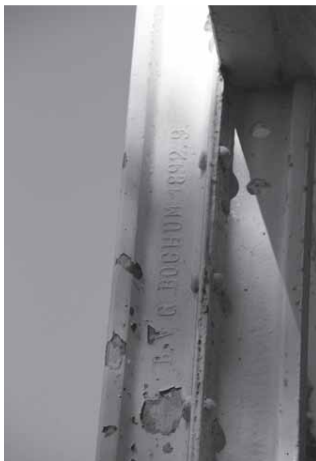
Fig. 12 - Pormenor da estrutura metálica de suporte da galeria de cura, onde é visível a origem e data de fabrico. Pedro Gago, 2022.
