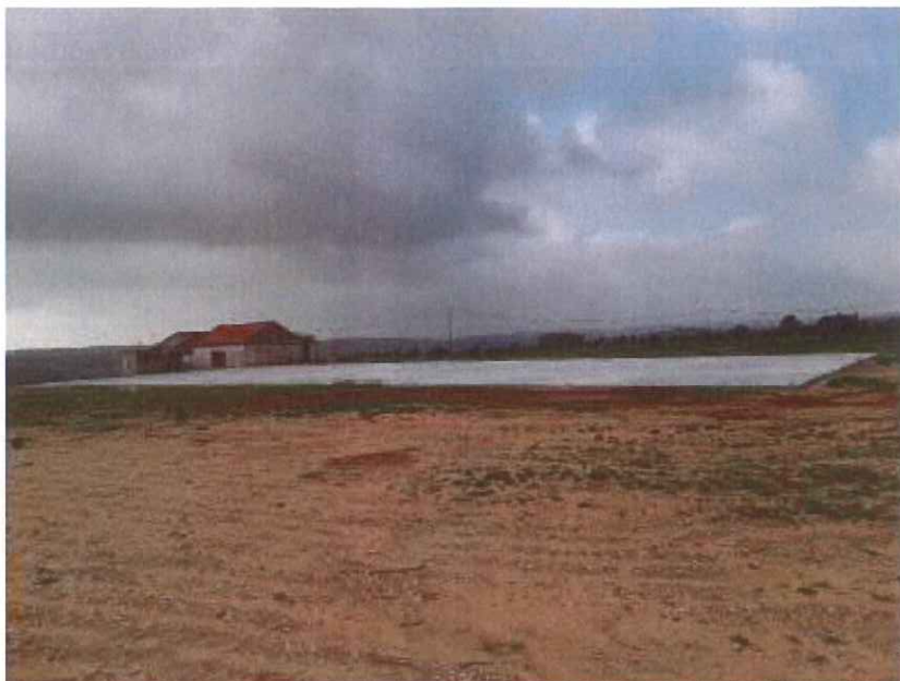
Fotografia da obra executada, plataforma em massame de betão, sem autorização prévia.
